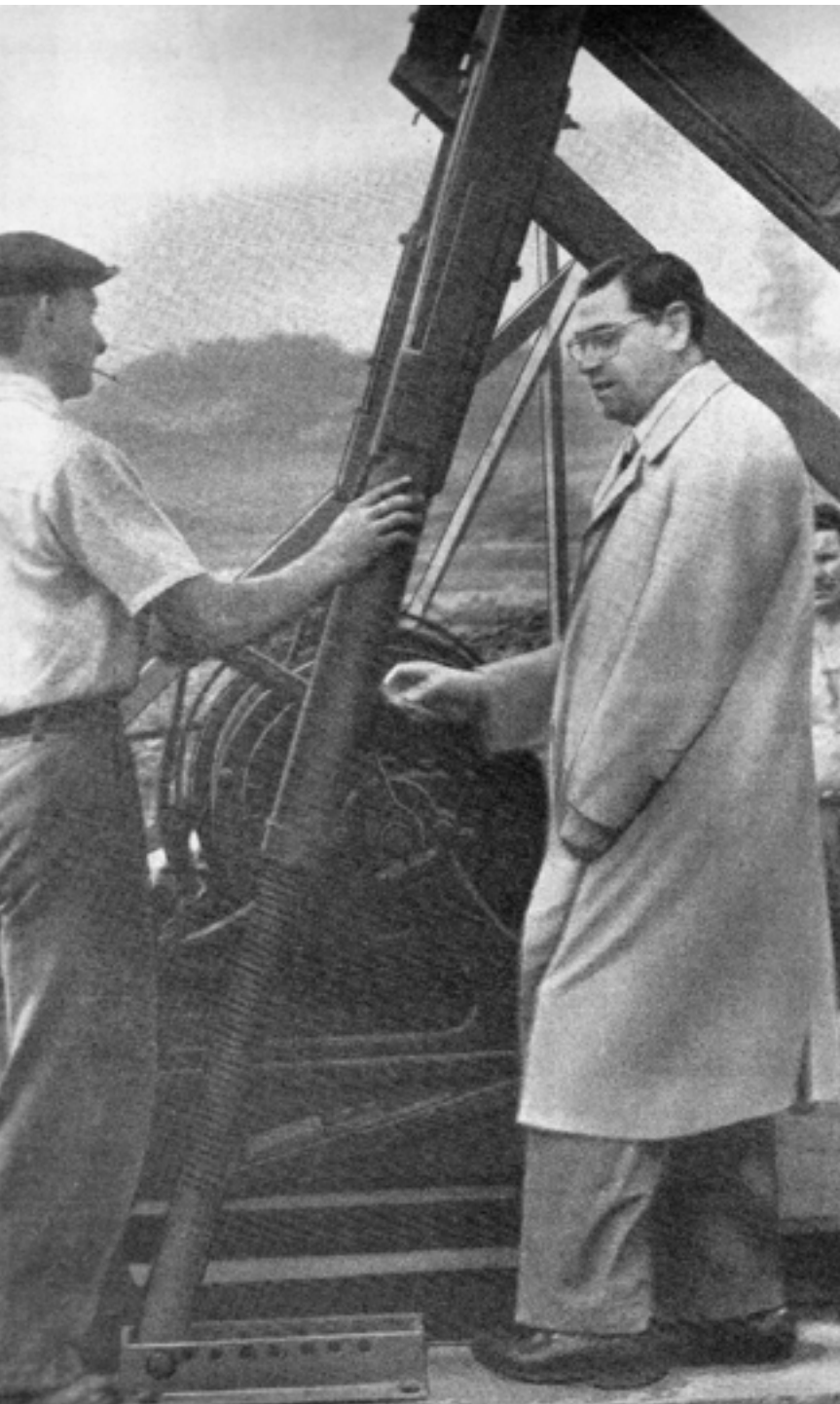
Ernesto de Moraes Leme crava a primeira estaca do Edifício da Reitoria
